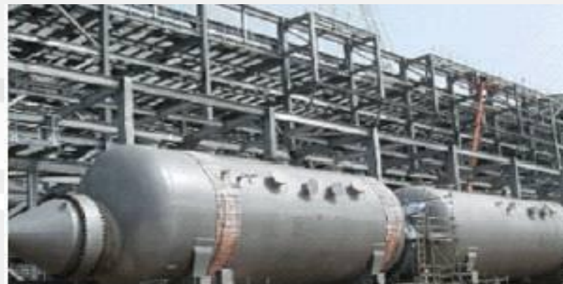
Doosan Mecatec, Južná Kórea - rúrové výmenníky tepla
